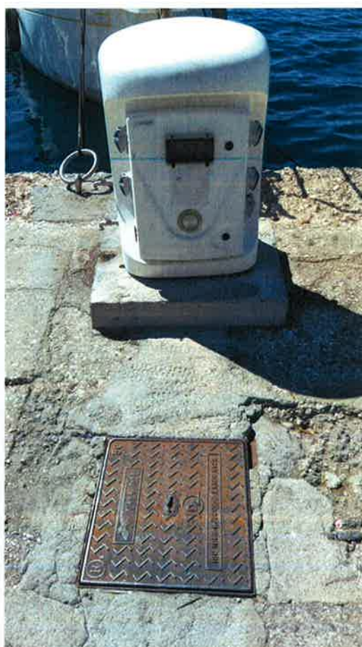
Εικόνα 3- Θραύση σκυροδέματος- ασυνεχείς σκυροδετήσεις - ανισοσταθμίες καλυμμάτων φρεατίων
