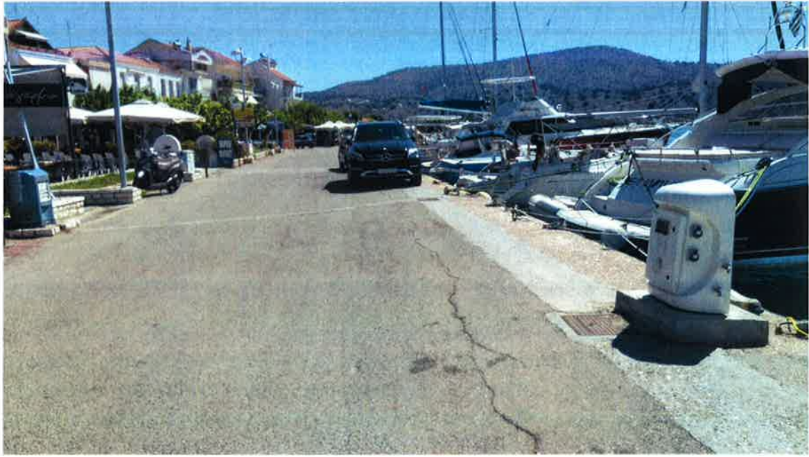
Εικόνα 6- Έντονες ρηγματώσεις και σκυροδετήσεις σε διαφορετικό χρόνο
