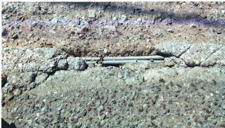
Εικόνα 2- Θραύση σκυροδέματος και αποκάλυψη σωληνώσεων
